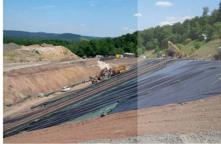
Einbau der Basisabdichtung an der Böschung des fünften Deponieabschnitts der Deponie Hamberg
