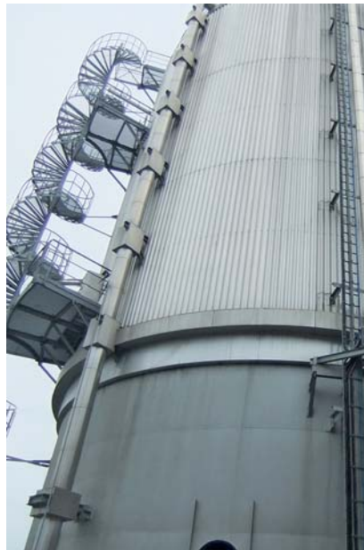
In der Vergärungsanlage in Leonberg wird der Bioabfall aus dem Enzkreis verarbeitet
